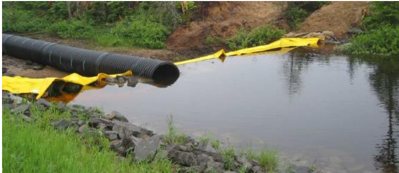
Exemple de batardeau* et de buse assurant la continuité de l'écoulement hydraulique
